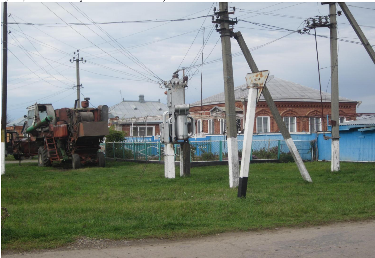
Трансформаторная подстанция-100 кВт. ул.Шовгенова и Кузнечная. Надписей нет. Изолятор висит.
