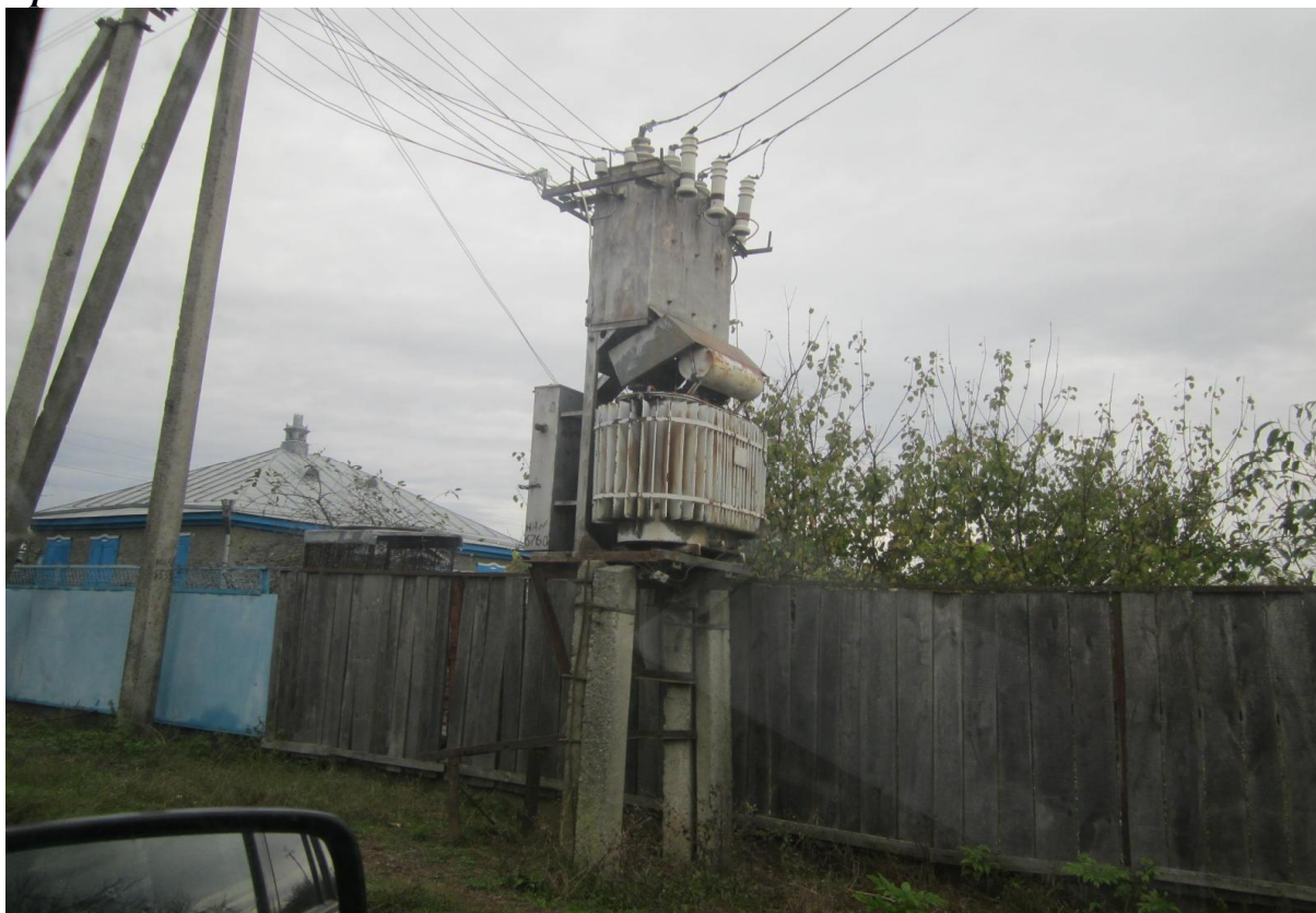
Трансформаторная подстанция-100 кВт. ул.Андрухаева. Нет надписей. Ржавый.
