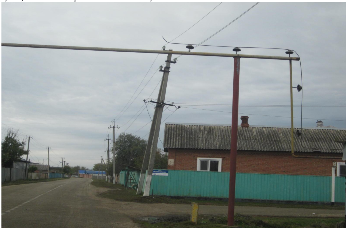
Линия электропередач. ул.Первомайская. Столб скоро упадет на дом. Нет ограждения от наезда. Нет надписей.
