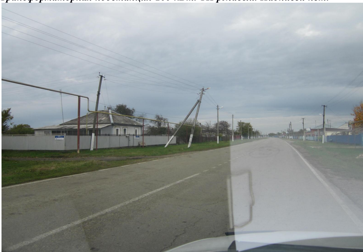
Линия электропередач. Столбы сильно наклонены, скоро упадут на дорогу.
