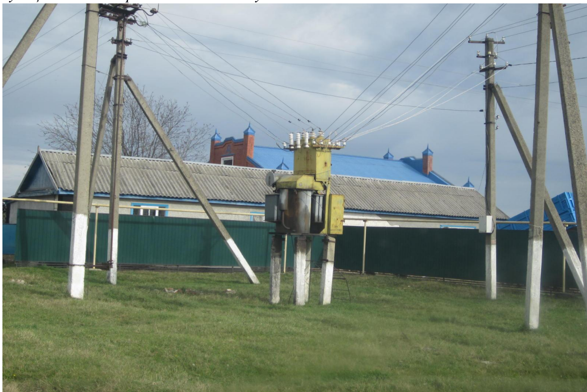
Трансформаторная подстанция-160 кВт. ул. Ленина. ТП замаслен. Ржавый. Надписей нет.
