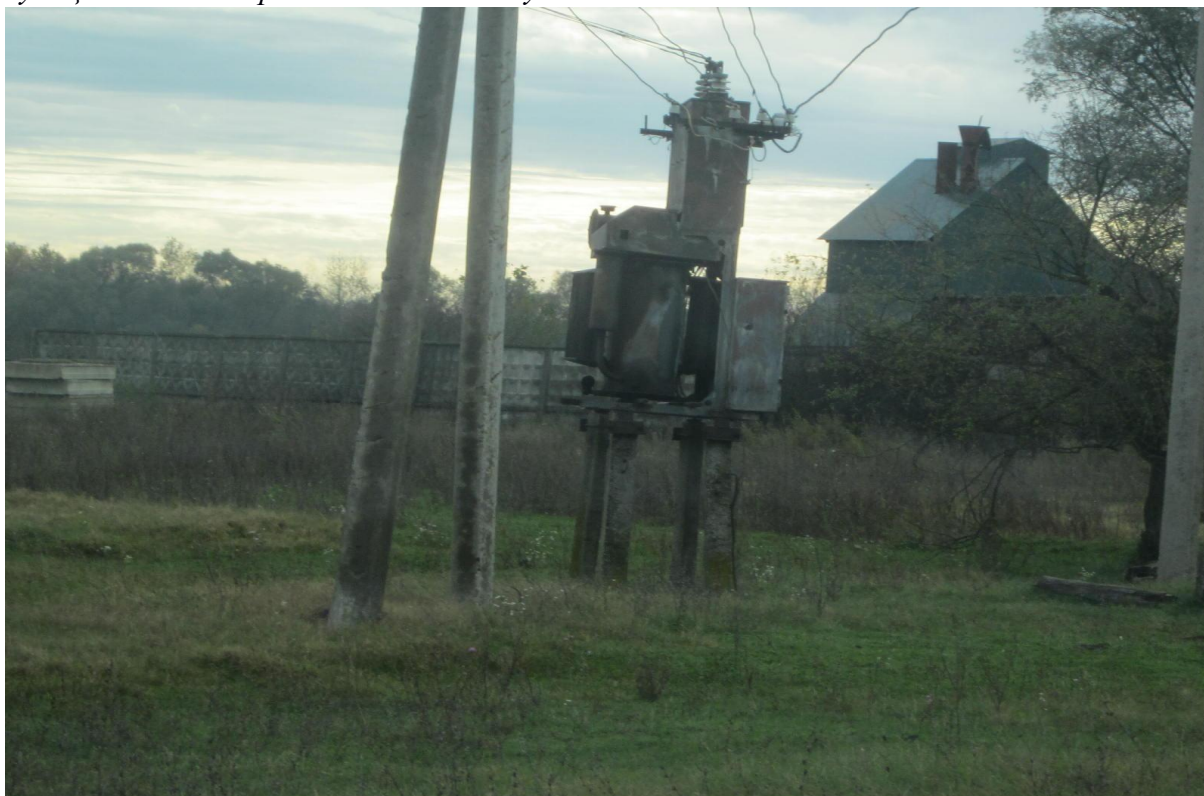
Трансформаторная подстанция-65 кВт. ТП замаслен. Нет надписей. Столбы не покрашены.
