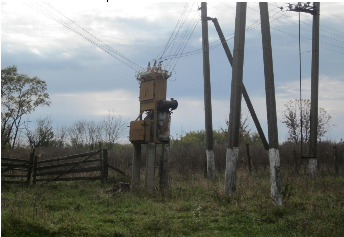
Трансформаторная подстанция- 100 кВт. ул. Пролетарская. ТП замаслен. Стоит криво. Ржавый. Нет надписей.
