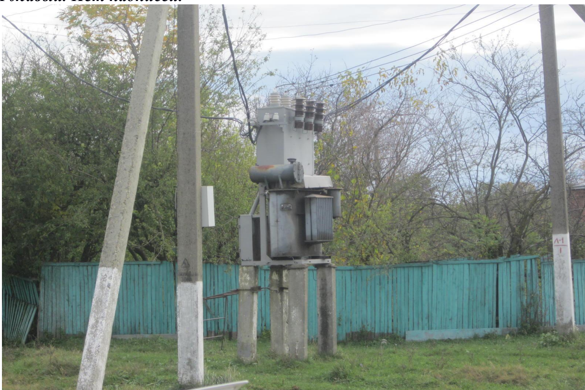
Трансформаторная подстанция-100 кВт. а.Кабехабль. ул.Ленина. ТП замавлен. Ржавый. Нет надписей.
