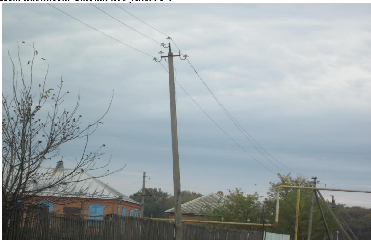
ЛЭП-10 кВт. Столб стоит с наклоном 6°.
