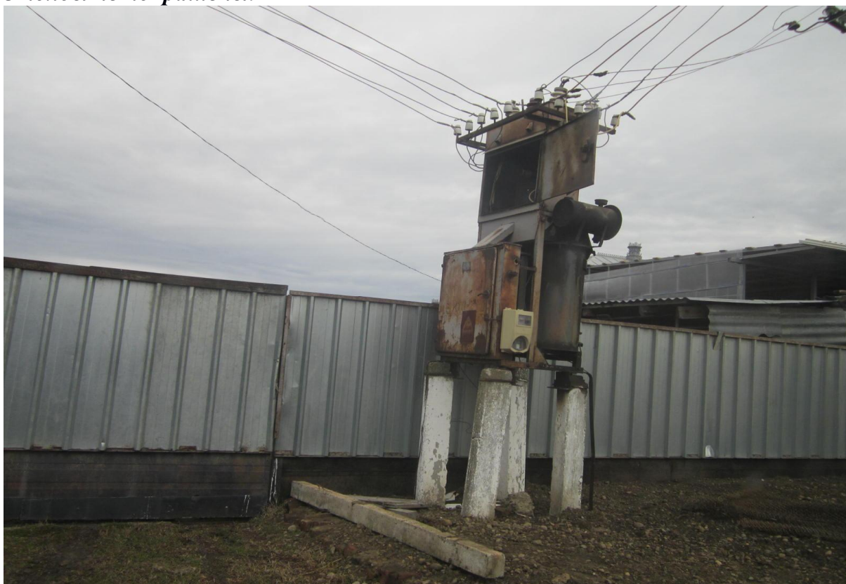
Трансформаторная подстанция-100кВт. ул.Пишизова. ТП замаслен. Ржавый. Надписей нет.
