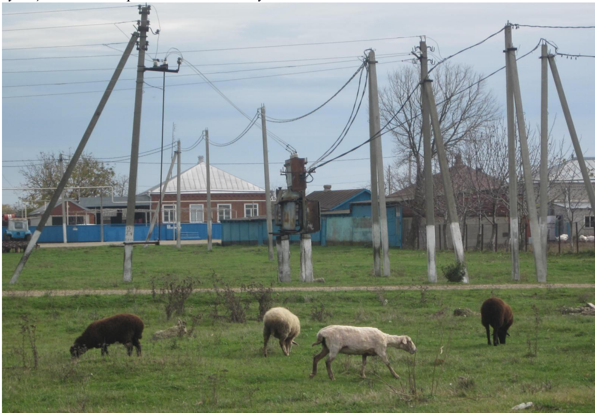
Трансформаторная подстанция-100 кВт. ул.Кузнечная. Стоит под углом 3°. Ржавый. Нет надписей.
