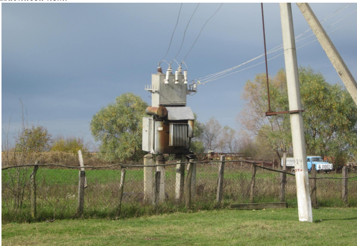
Трансформаторная подстанция-100 кВт. а.Пиичо. ул.Новоселов. ТП замаслен. Стоит по углом 4°. Ржавый. Надписей нет.
