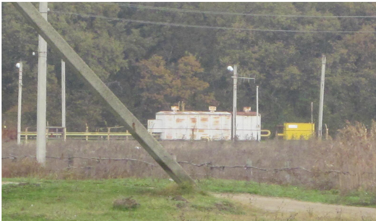
ГРС. Распределительная подстанция. а. Пиизов.
