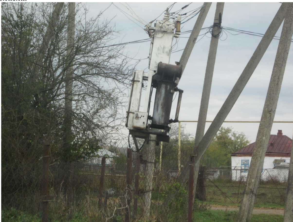
Трансформаторная подстанция-100 кВт. ТП замаслен, стоит под углом 4°. Столб стоит криво. Надписей нет.
