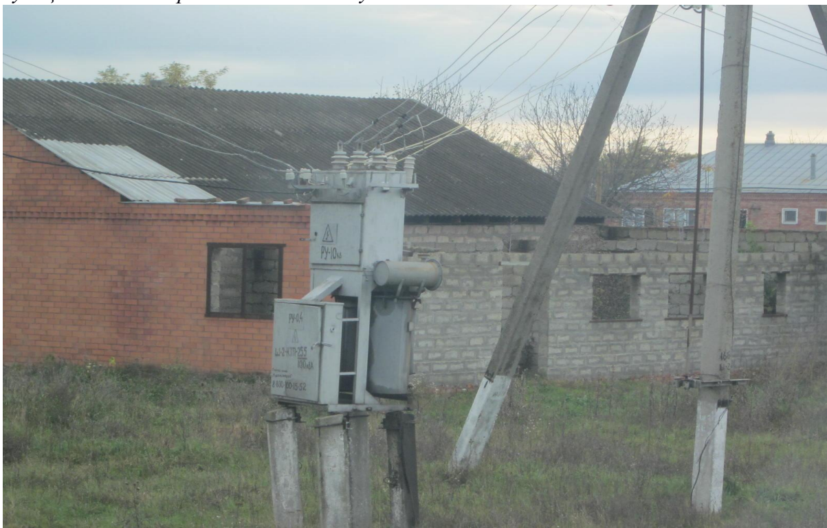
Трансформаторная подстанция-100 кВт ул.М.Шовгенова. Стоит с наклоном 3°. Нет надписей. Замаслен.
