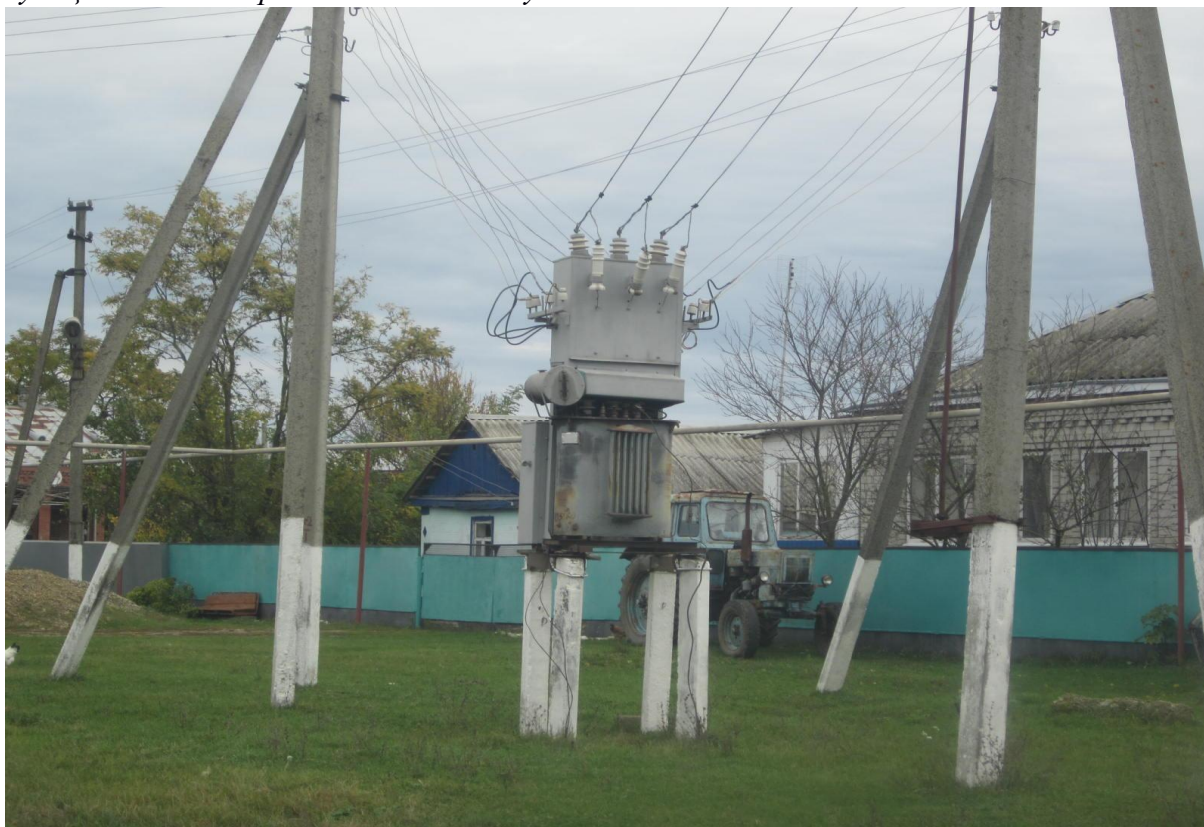
Трансформаторная подстанция-100 кВт. ТП ржавый. Надписей нет.
