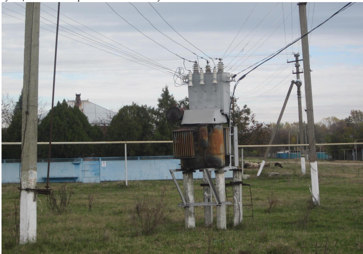
Трансформаторная подстанция-160 кВт. Ржавый. Нет надписей. Замаслен.
