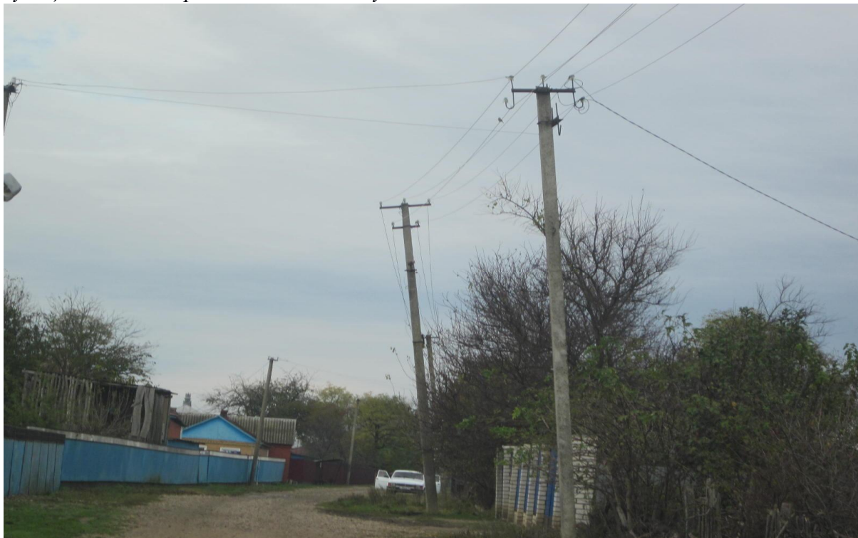
Линия электропередач. Столб стоит с наклоном 9°. Создает угрозу для жизни.
