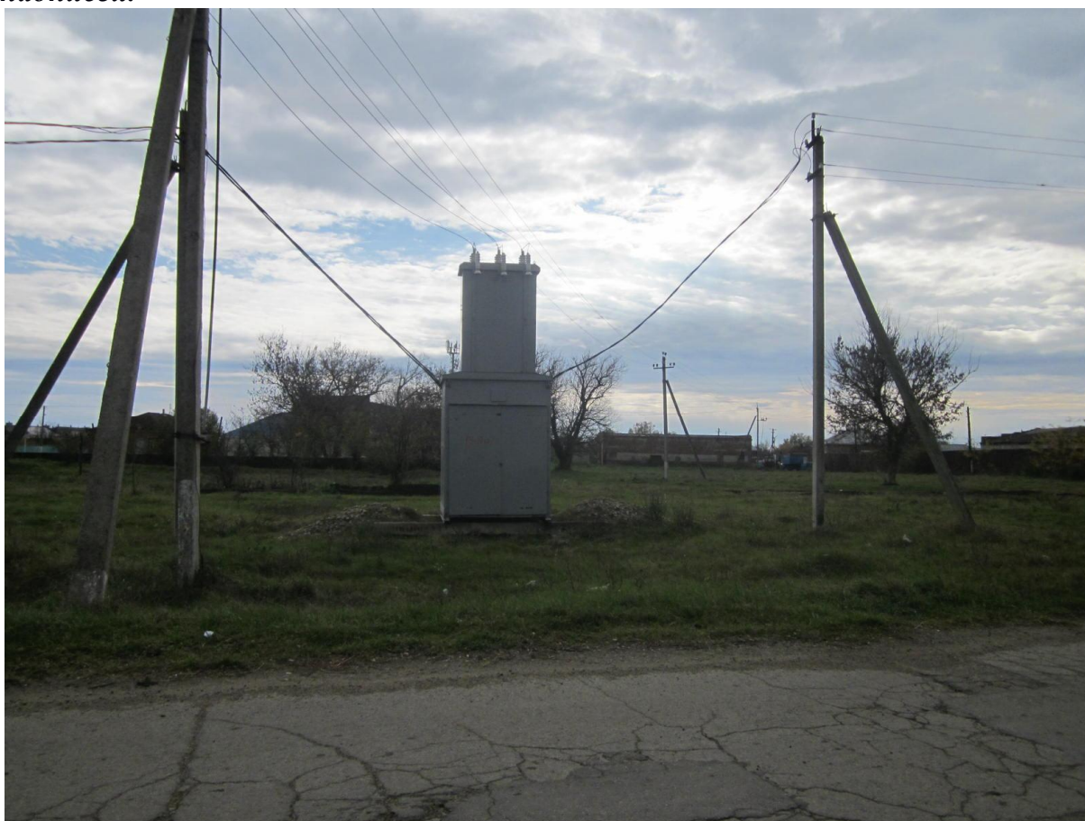
Трансформаторная подстанция -160 кВт. а.Пишчо. Нет надписей.
