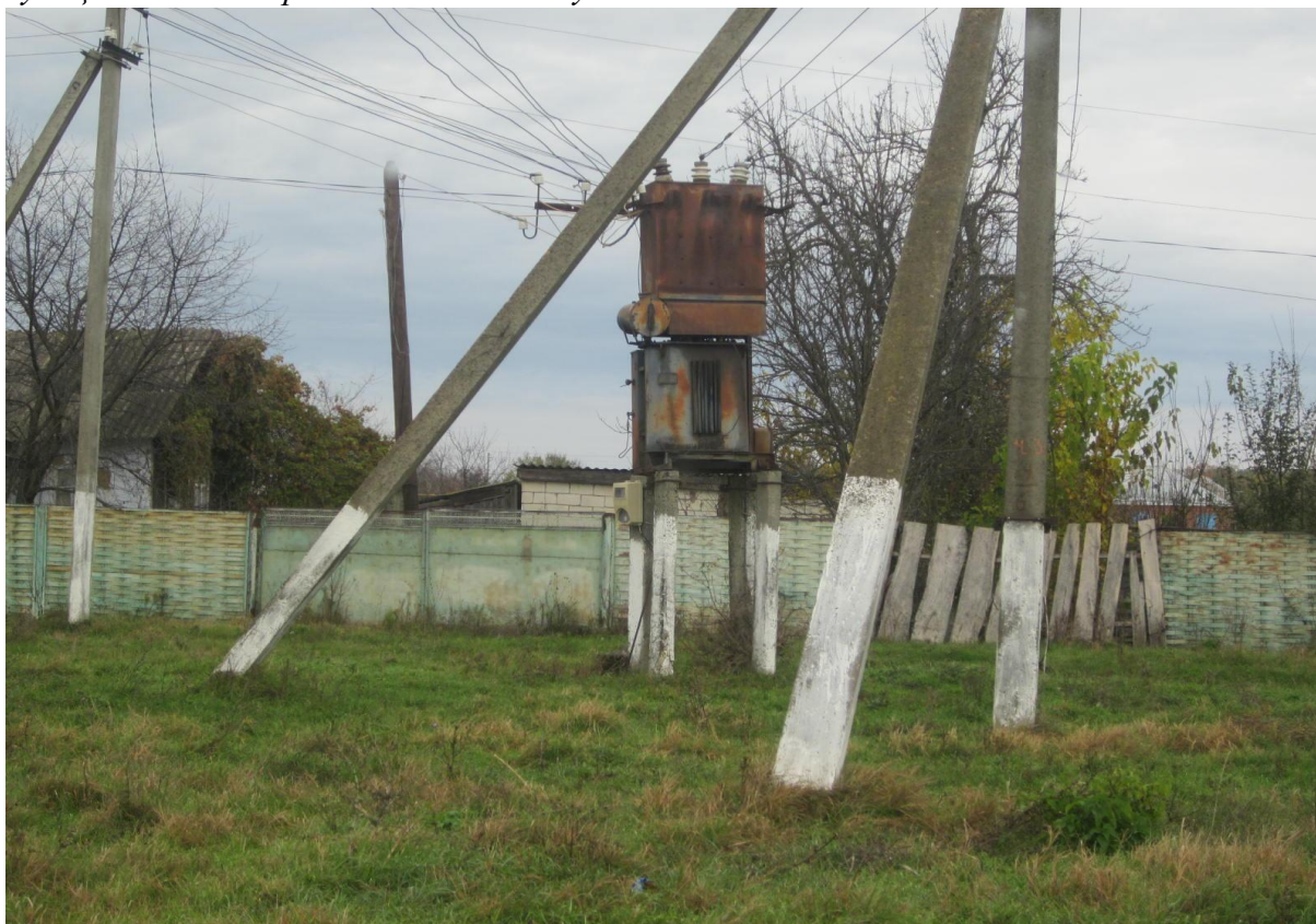
а.Пишизов. Трансформаторная подстанция-100 кВт.ул.Пишизов. ТП ржавый. Нет надписей. Стоит под углом 3°.
